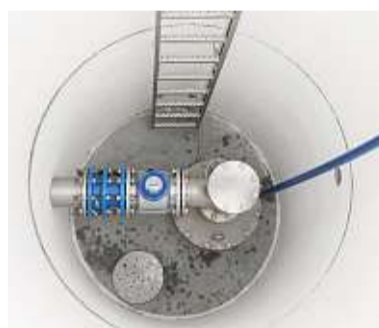
Průtokoměr umístěný v šachtici
