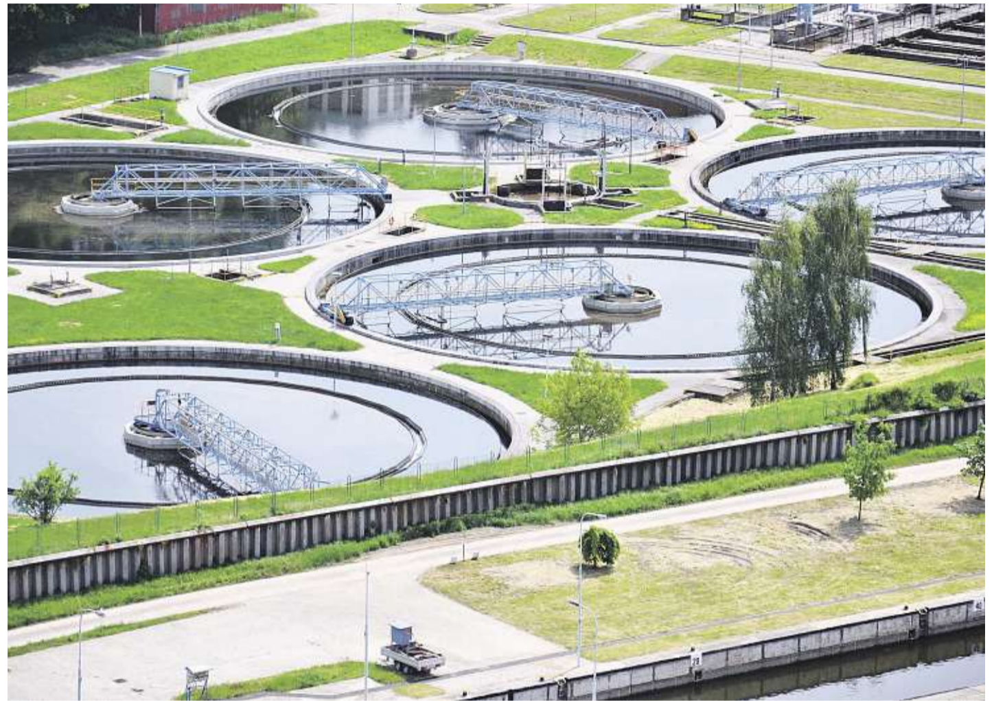
Čistější voda, zdravější krajina. Evropské dotace mimo jiné pomohou obcím vybudovat kanalizace, díky kterým znečištěná voda zamíří do čistíren odpadních vod (na fotce), a nikoliv do krajiny či do řek. Menší obce peníze využijí na vybudování soustavy domácích čistíren. Foto: Shutterstock
